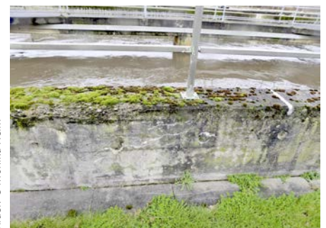
(2) Ist-Zustand zum Ortstermin eines Bauwerks mit Pflanzenbewuchs
