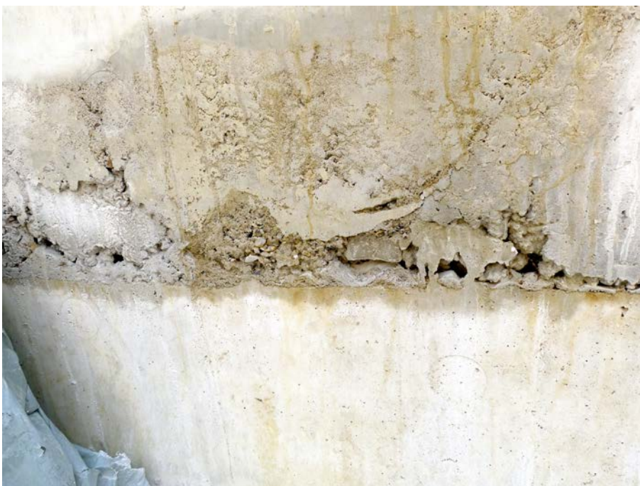
(1) Sichtbare Betonschäden im Zuge eines Neubaus: Teilweise liegen hier der Abstandshalter und die Bewehrung offen.
