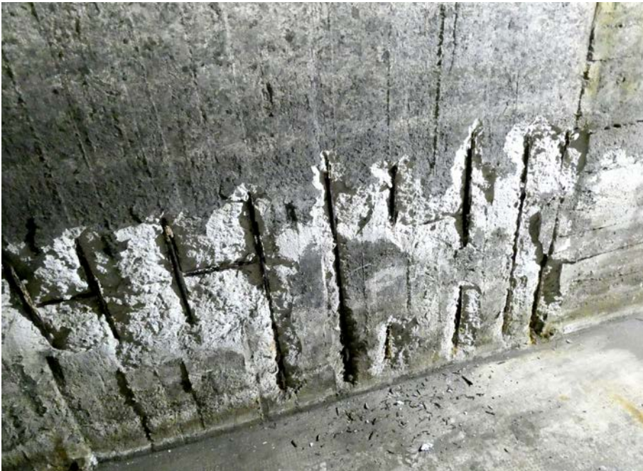
(3) Freiliegende Bewehrung ohne Untergrundvorbereitung
