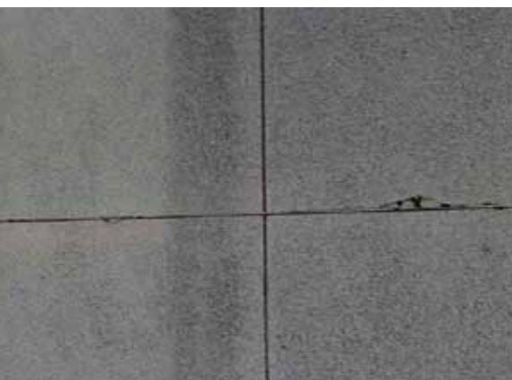
„Betonkrebs“ ist in aller Munde.
