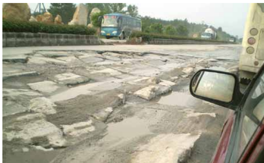
...damit Zustände, wie auf der Betonstraße in China bald der Vergangenheit angehören.
