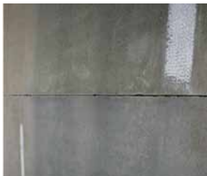
Kantenschaden an Fugen.
