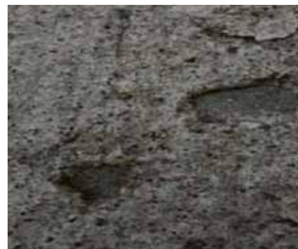
Abplatzungen an Betonoberfläche.
